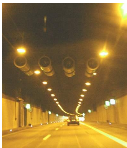
Vortex VAR TwinPipe zur Ventilator-Steuerung
